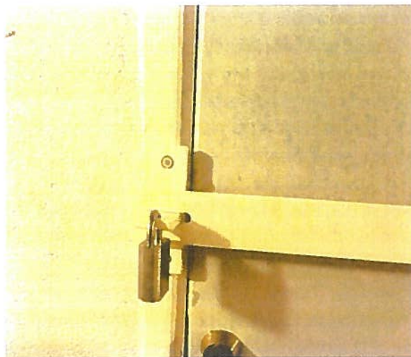
En låsbom med separat nyckel till förråd Tbv 46-54
