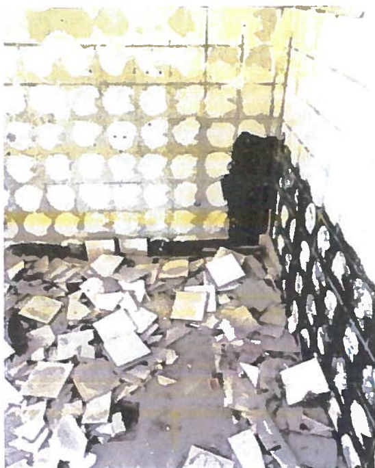
Exempel på bristfälligt yt och tätskikt i ett badrum
